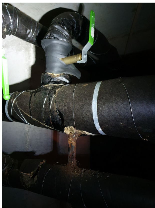
Läckande tappvattenledningar i krypgrunder
