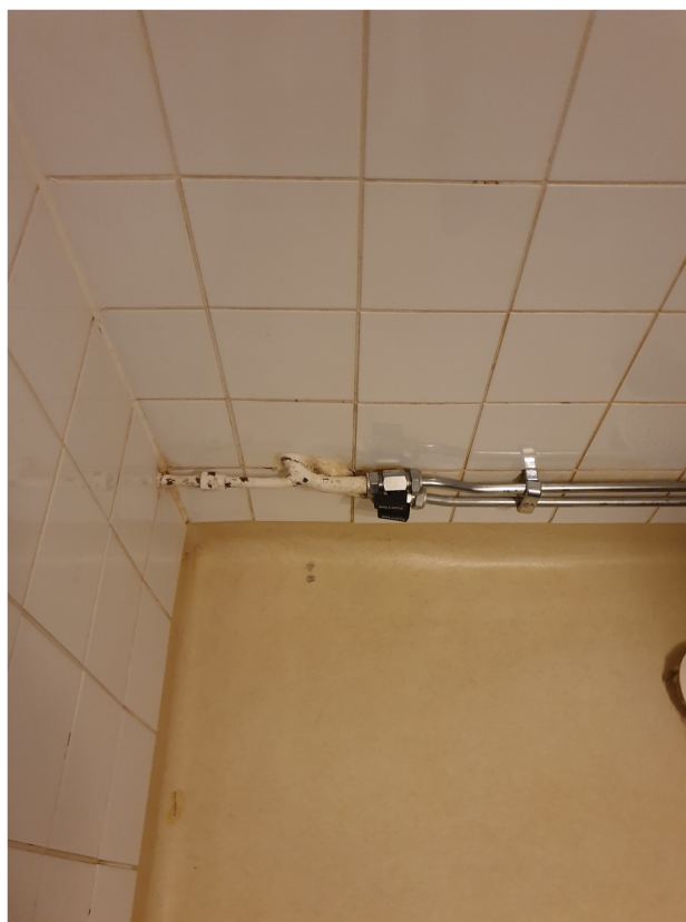
Tappvattenledningar ut ur vägg nedtill i extra duschrum, i duschzonen, utan tätning mot vägg
