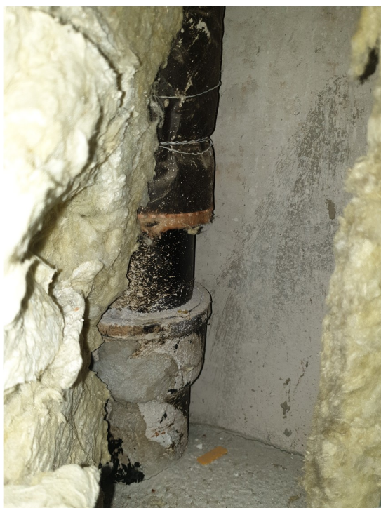
Dåligt avloppsrör i våtrumsschakt
