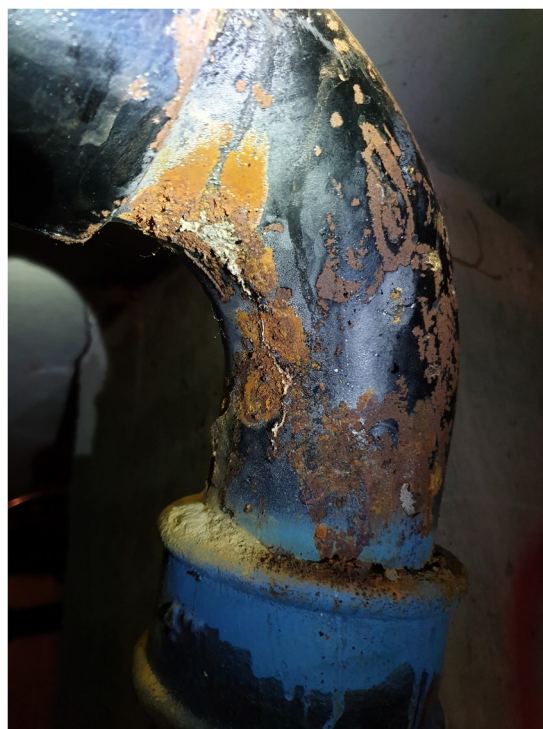
Rostig avloppsstam i krypgrund
