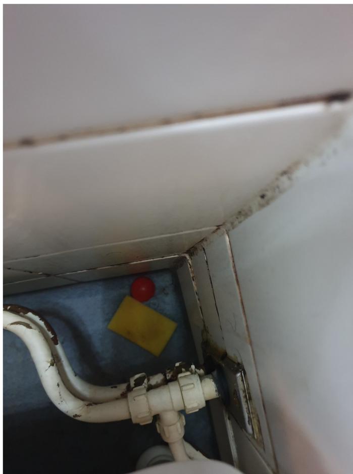
Våtrum med lösa kakelplattor på vägg och lös plastmatta på golvet
